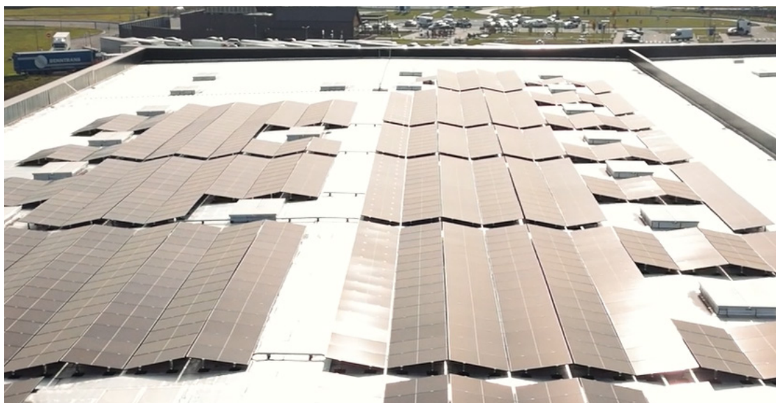
Toiture photovoltaïque de Pro à Pro à Duppigheim (67)
