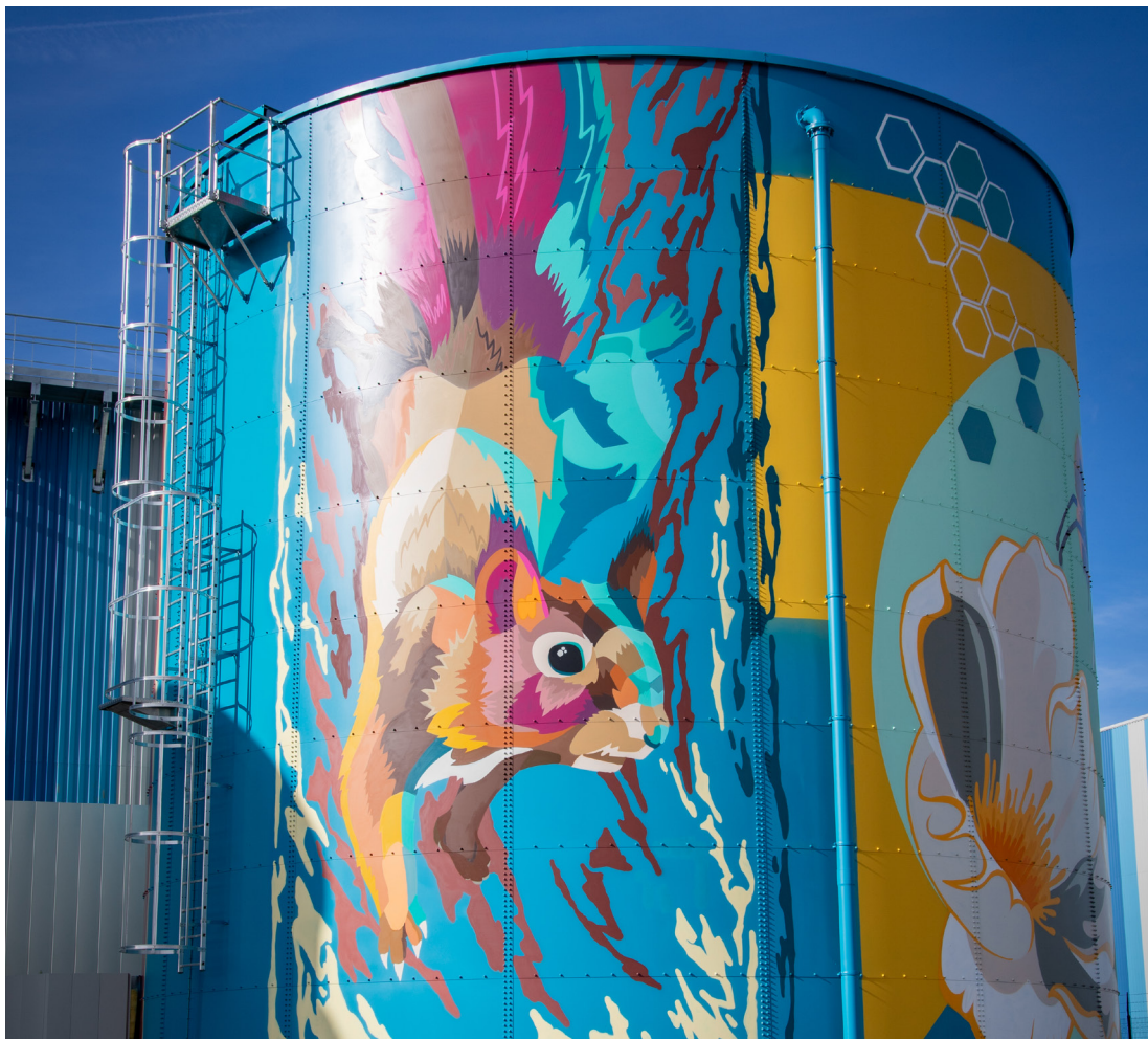
Cuve sprinkler à Bresles (60)
