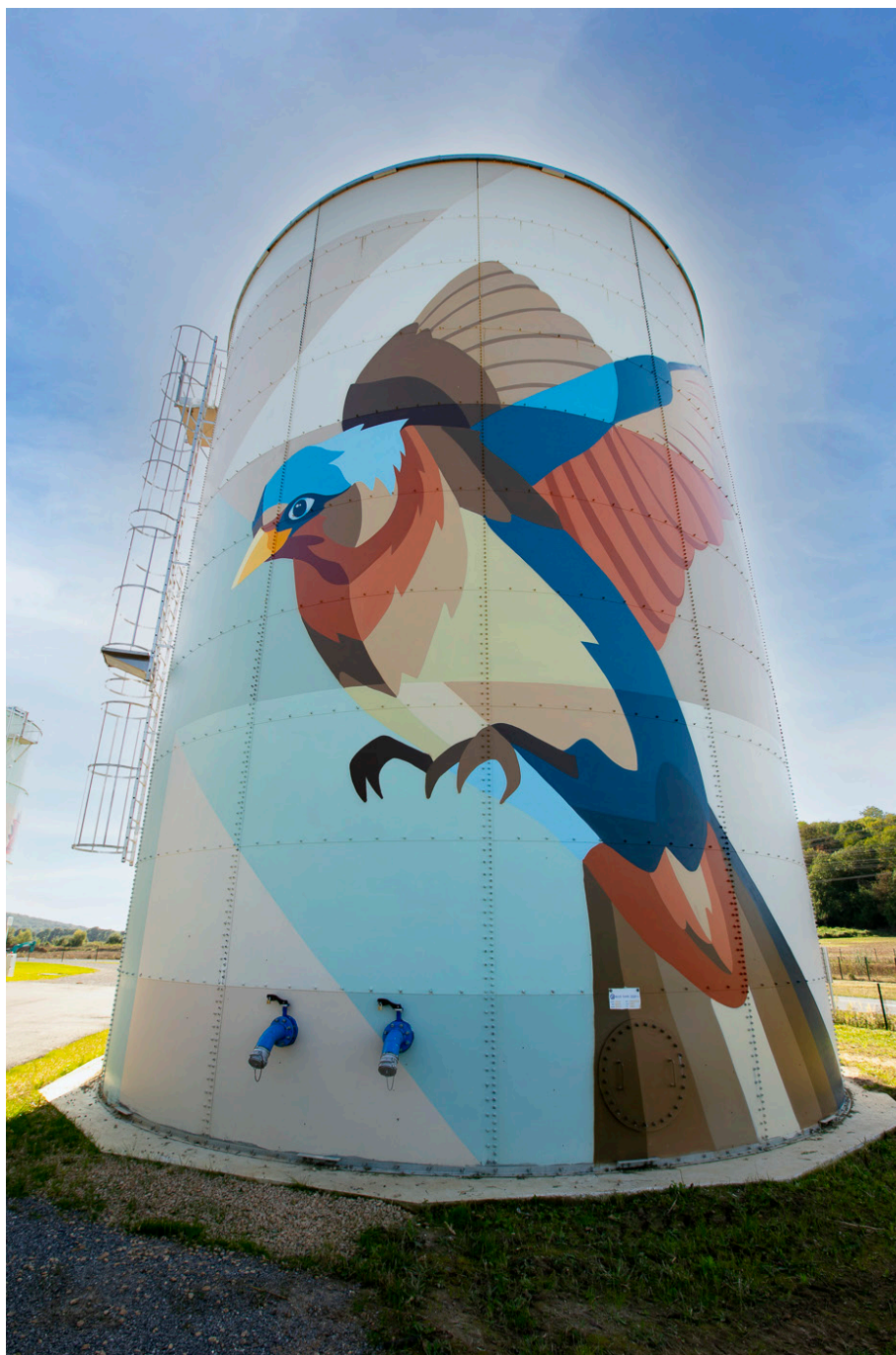
Cuve sprinkler réalisée par Kat Action (Offside Studio) à Bresles (60).
